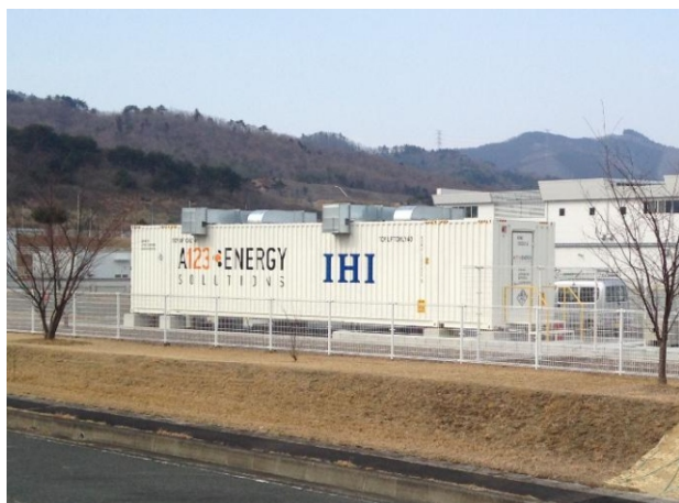
Система накопления энергии 1 МВт/2.8 МВт ч, установленная в Японии. Проект был сдан в эксплуатацию в марте 2014 г. и используется для сглаживания пиковых нагрузок и управления зарядом. (Фото: A123 Energy Solutions).
